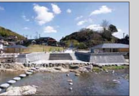
⑬ 恩湯と親水広場「恩湯広場」(2020年3月開業。写真は工事中) 竹林の階段から恩湯広場、飛び石へとつながる。
